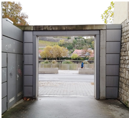
nábřeží - protipovodňová vrata
