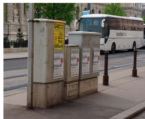
365 Skříně technické infrastruktury je vhodné umístit v ose sloupů, kde nepřekáží v prostoru, případně přecházení ulice [ Rakousko, Vídeň ]
