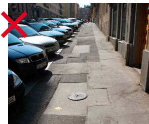
358 Současná podoba povrchů v Praze vychází z požadavků opravit vždy jen pruh nutný pro výkop. Pro obnovu povrchů by bylo vhodné hledat prostředky pro zvyšující kvalitu, zejména pomocí kvalitní koordinace investic [ Praha 7, Letná ]
