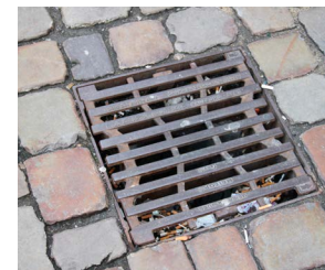
356 Pro dlážděné povrchy je z hlediska skladby vhodnější používat poklopy čtvercového tvaru, namísto kruhových [ Praha ]
