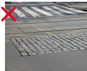
226 Záplata opatřená nevhodným materiálem nenavazujícím na okolní povrch [ Praha 2, Karlovo náměstí ]
