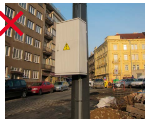
247 Prvek umístěný na jiném prvku nerespektuje barevnost a povrchovou úpravu prvku nosného [ Praha 10, Moskevská ]
