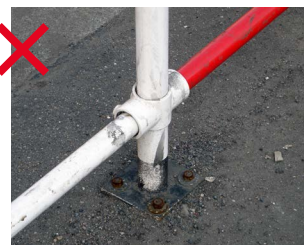
495 Nevhodně řešený detail spojení a ukotvení zábradlí. Detail je složitý, vytváří potenciální příležitost ke zničení, zanášení špínou [ Praha 6, Dejvická ]
