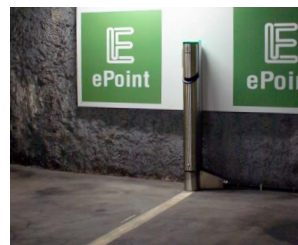
556 Dobíjecí terminály pro elektromobily by měly mít kultivovanou formu a měly by být umístovány v blízkosti parkovacích míst [ Praha ]
