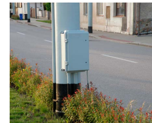
361 Minimalizovaná skříň umístěná na sloupu trakčního vedení, opatřená shodným nátěrem a nepřekážející v prostoru může být vhodnou náhradou samostatně stojící skříňě. Vždy je třeba navrhovat s ohledem na navazující prostranství [ Lázně Bohdaneč, Šípkova ]
