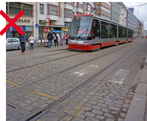
236 Různě vzdálené zakončení různorodého povrchu v rámci křižovatky je z celkového vnímání prostoru nevhodné. Křižovatka by měla mít celkově jednotný povrch s jasným vymezením oproti navazujícímu povrchu ulice [ Praha 2, Karlovo náměstí ]
