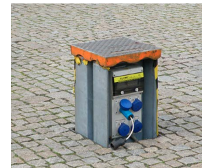
355 Skrytý prvek přípojného místa energií pro kulturní akce a trhy na veřejných prostranstvích [ Kolín, Karlovo náměstí ]
